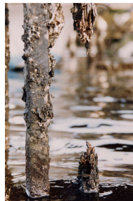
18ヶ月後、右側の木柱は完全に腐食
