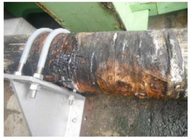
④他箇所の腐食部分を確認。
