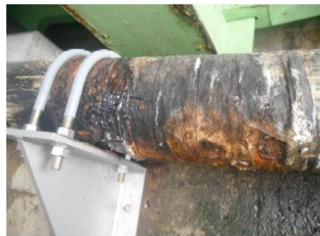
④他箇所の腐食部分を確認。
