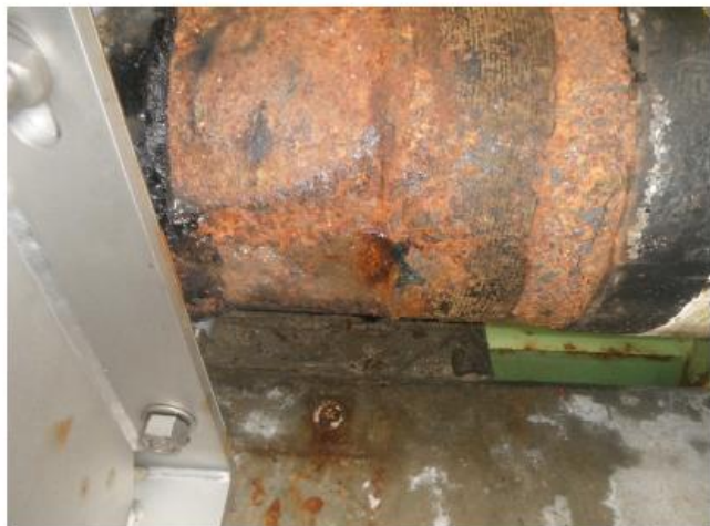
①漏水箇所の確認をする。
