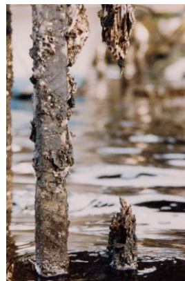
18ヶ月後、右側の木柱は完全に腐食
