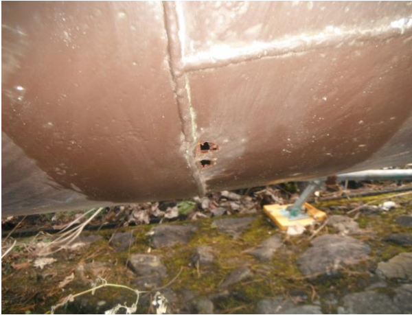
①施工前 傷口を確認、20mm程の穴が2箇所羅列している状況
