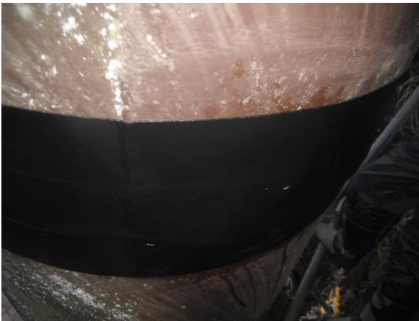
③施工中 ②の作業後、更に防食効果を高める目的で、ブチルロール(下地用ブチルゴム)を貼り合わせていく。
